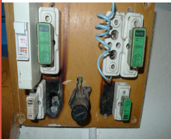
Branchements d'électricité vétustes
