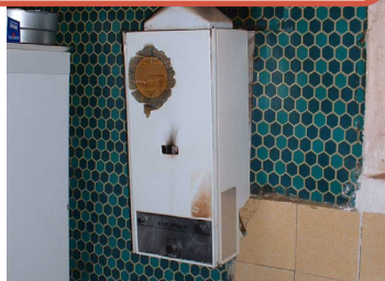
Absence de dispositif d'évacuation des gaz brûlés
