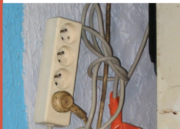
Installation électrique dangereuse
