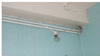
Eclairage insuffisant et dangereux
