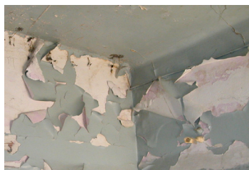
Peinture écaillée contenant du plomb
