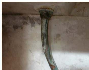
Absence de siphon
