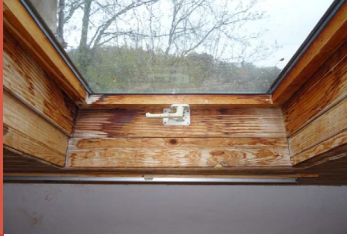
Absence de protection contre les infiltrations d'eau
