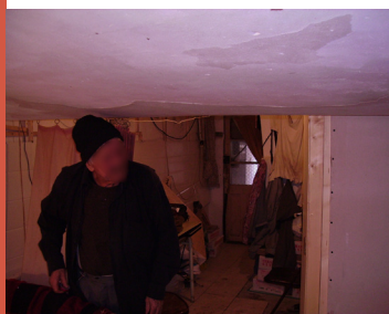
Hauteur sous plafond insuffisante
